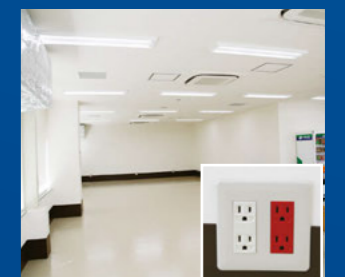
3층 정전 대비 구역 (적색 콘센트는 정전 시에도 사용 가능)
