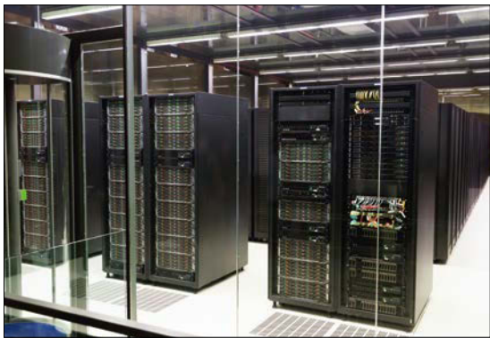
図1 データセンターの例
