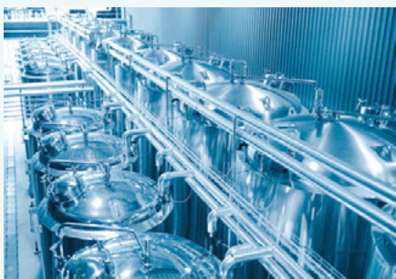
図：PAの導入現場 (アルコール飲料工場の麦汁発酵タンク)
