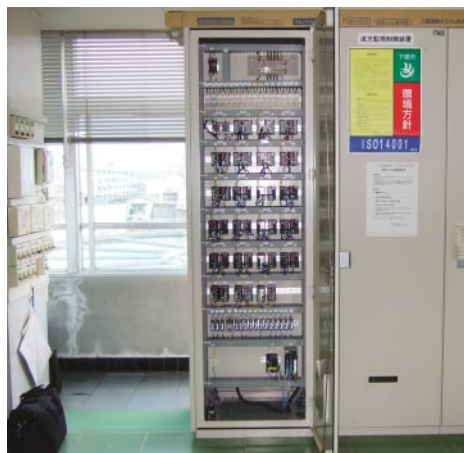
図4 長府浄水場にある監視盤
