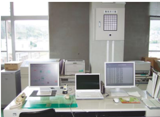
図1 長府浄水場の中央監視室にある監視用パソコン
