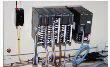
図5 新工場の集中計器(電力量)盤に設置されたリモートI/O R3シリーズ
