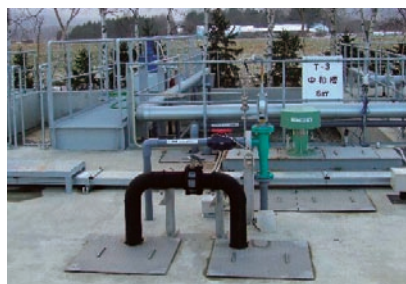
図4 排水処理施設
