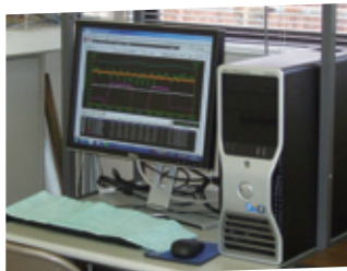
図2 事務所の監視用パソコン
