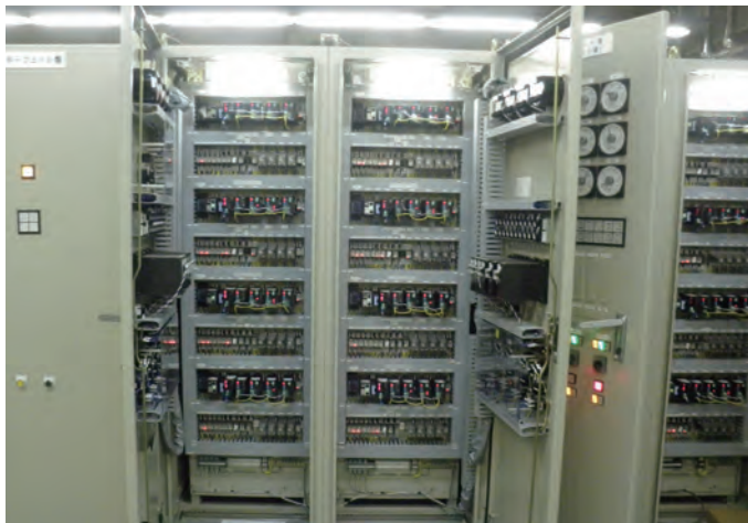
図2 数年前に導入した取水ポンプ施設監視用テレメータ盤
