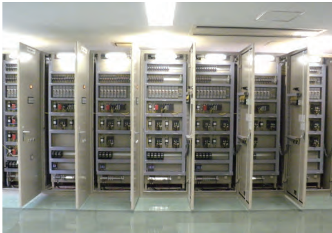
図1 豊井浄水場のコントローラテレメータ盤
