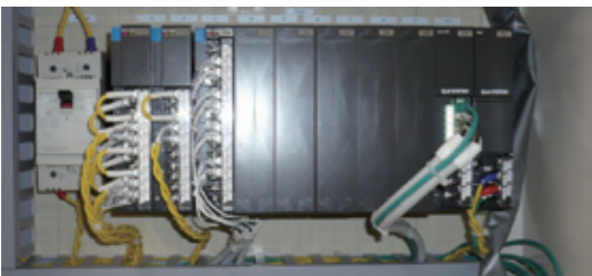
図1 電気室の盤内に設置されたリモートI/O R3シリーズ
