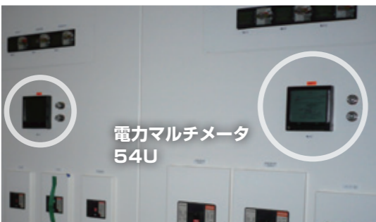
図2 電気室の盤内に設置された電力マルチメータ54U
