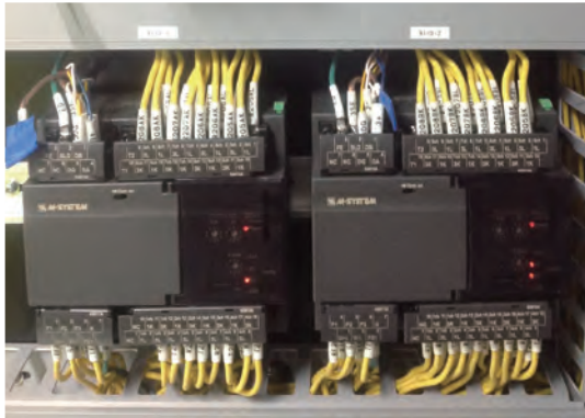
図2 データセンタに設置されたリモートI/O R9MWTU
