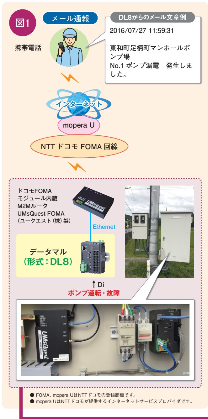
登米市東和町 足柄町マンホールポンプ場 ほか7機場
