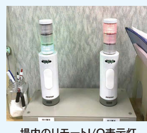
場内のリモートI/O表示灯
