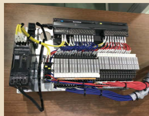
写真3： 導通検査機器 リモートI/O
