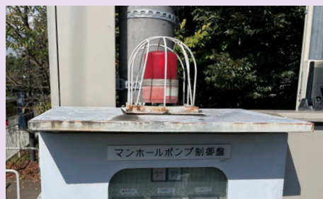
制御盤に取付けている警報灯
