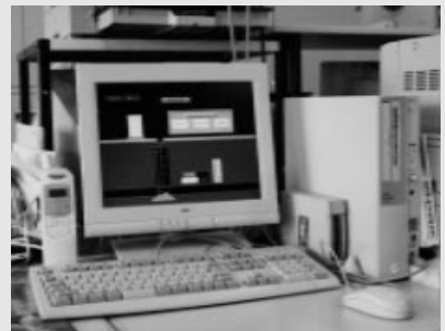
▲役場内に置かれた監視用モニタ装置
