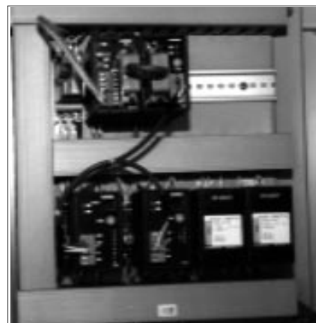
図2 子局(目高浄水場)の計装盤に実装されているテレメータ機器(形式: MOD1、SMDM、SML)と変換器
