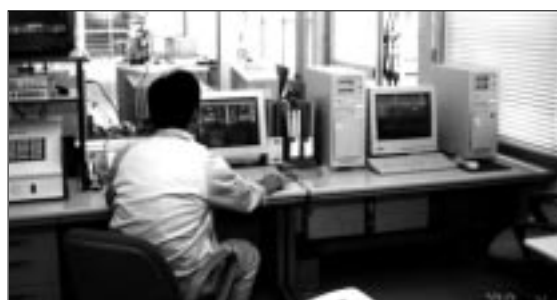
図3 監視室に置かれた2台のオペレータズユニット
