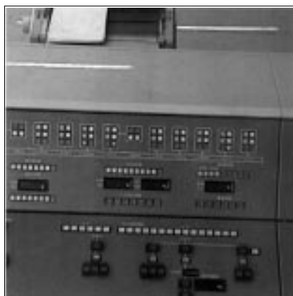
図5 土地改良区事務所で受信した盤の画像
