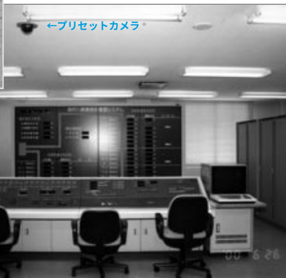
図1 中央管理所の監視盤とプリセットカメラ
