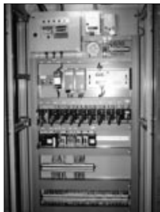
図3 子局側の計装盤(真駒内)
