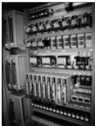
図2 親局側の計装盤(真駒内)
