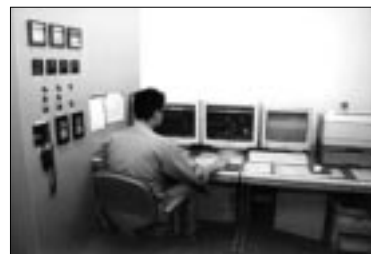
▲ 真駒内事業所監視室
