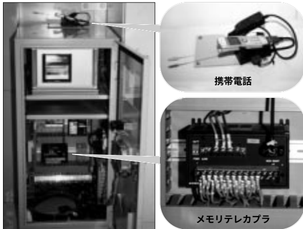
図4 現場盤に設置された携帯電話器(カバーを取り外した状態)とメモリテレカプラ(形式: TLZ1)
