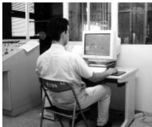
図2 監視室に置かれたオペレータズユニット (形式: OPU)
