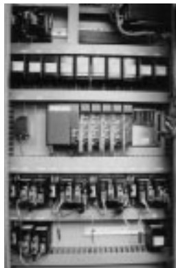
図2 中之郷浄水場のテレメータ盤
