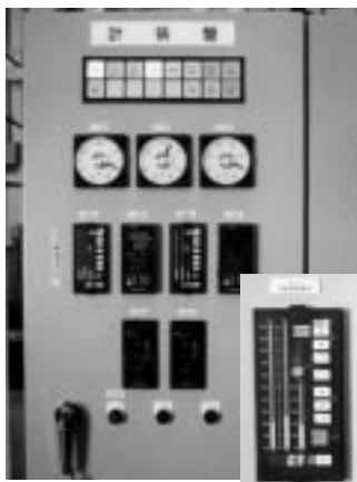
図4 石舟浄水場の計装盤。薬品注入のコントロールに“ワンループコントローラ”(形式: ABE)が2台使われている
