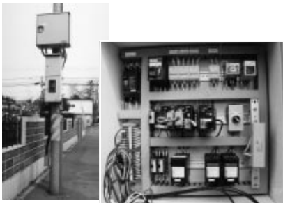
図2 路上局(子局)。柱上にテレメータ装置が取り付けられている
