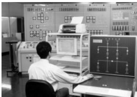
図3 中央監視室に置かれたパソコン
