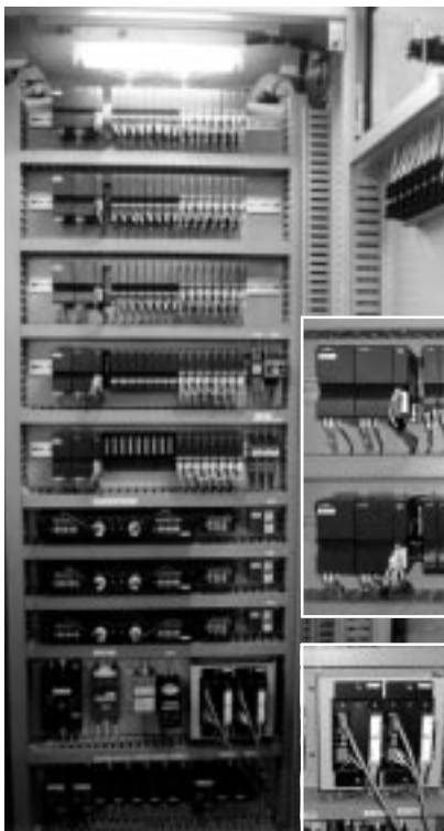
図3 大方町役場内にあるテレメータ盤の内部。右上は“R5シリーズ”、右下はRS-485をEthernetに変換する“プロトコル変換器”(形式：70EM)
