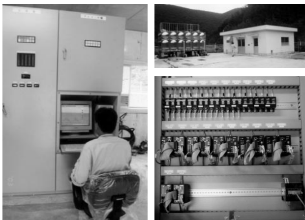
図3 中勝浄水場にあるテレメータ盤と盤内
