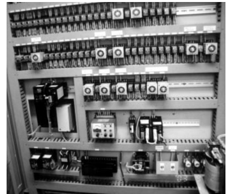
図5 “帯金・塩之沢浄化センター”の制御盤内部
