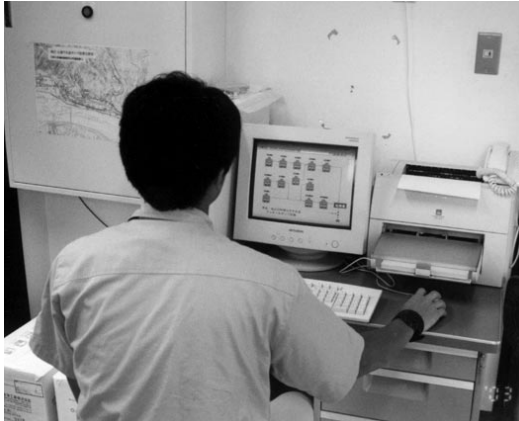
図3 “角打・丸滝浄化センター”内にある監視用パソコン
