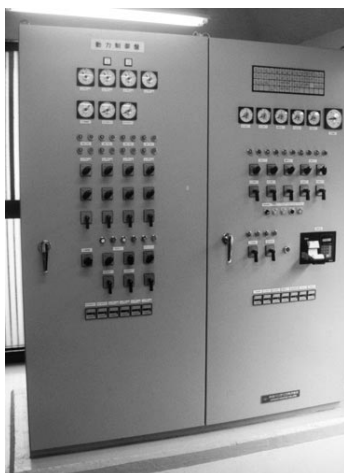
図4 “角打・丸滝浄化センター”の制御盤とその内部
