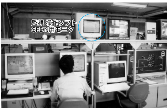
図2 “大島水源センター”の監視室
