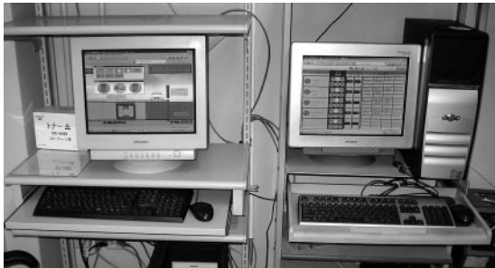
図4 碓井ポンプ場内にある監視用パソコン
