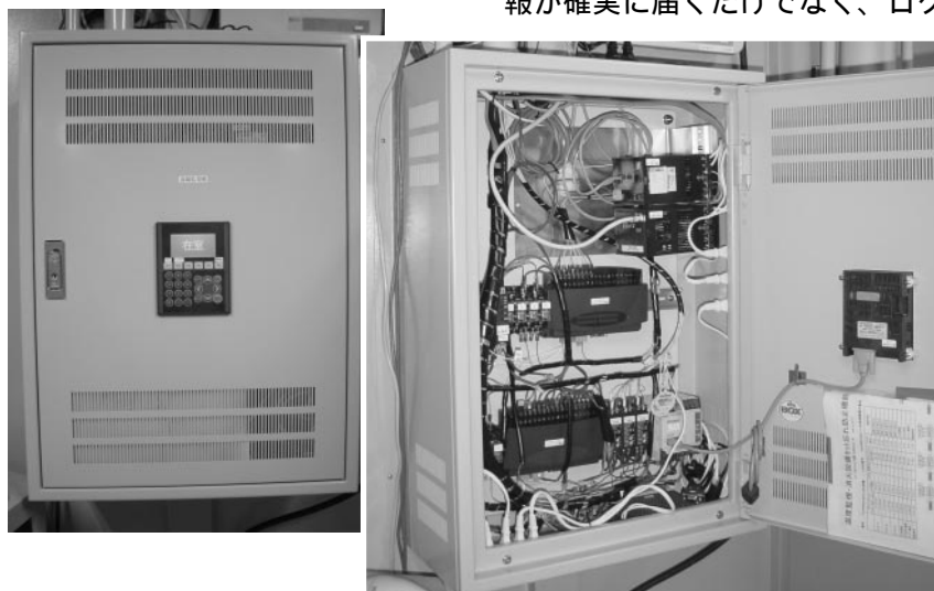
図4 遠隔監視盤とその内部に設置されたWebロガー(形式: TL2W)とてれまる(形式: TLO)
