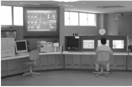
図3 千代川浄水場内にある監視室 代川水系の2つに大別されています。これら2つの系統には、水源、ポンプ場、配水池など約20箇所の施設があり、それらが市内に散在しています。第4次拡張事業以来、施設における水位や流量、水質といった各種計測信号、設備故障などの警報信号を、NTTの専用線を用いてエム・システム技研製のテレメータ(“ジャストフィットテレメータ”やDASTシリーズ)装置で
